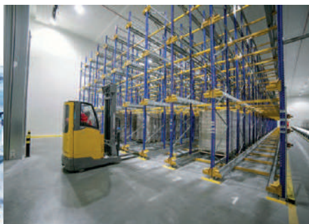
Magazyn -mroźnia. Wytwarzanie kostek lodu, od chwili pobrania wody z ujęcia, aż po paletyzację i etykietowanie gotowych wyrobów odbywa się w pełni automatycznie.
