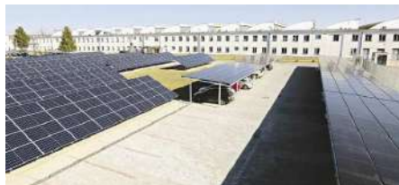
► ENERGIA W OFERCIE: W portfolio technologii Enervigo ma m.in. kogenerację, fotowoltaikę, magazyny energii, agregaty absorpcyjne czy moduły ORC. [FOT. ARC]
